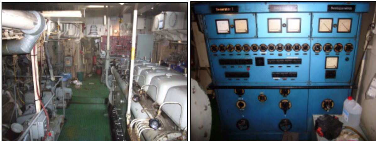
Voll funktionsfähig: Maschinenraum, Hauptschalttafel
